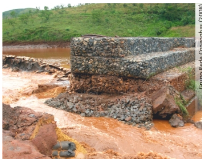
Barragem de rejeitos rompida (mina Casa de Pedra)
